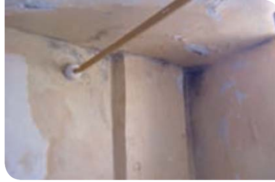
Katlar Arası Su Sızıntısı
