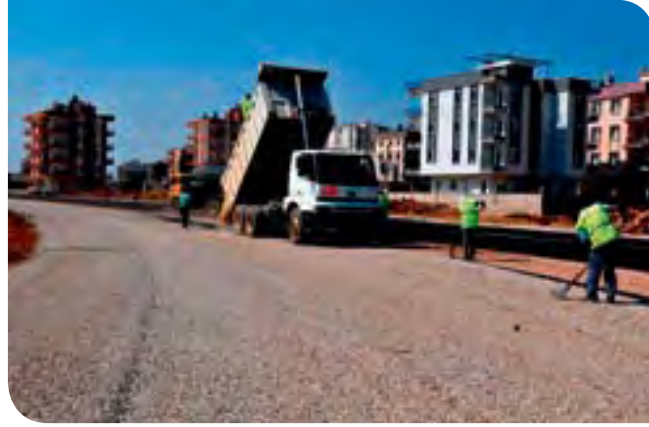
Hüsnü Karakaş Mahallesi Elmalı Hamdi Yazar Caddesi Sathi Kaplama Asfalt Dökümü Çalışması
