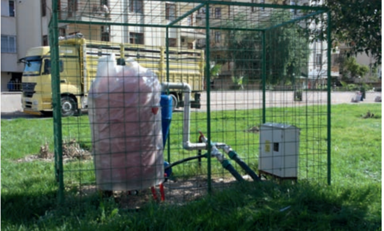
Kültür Mahallesi 3823 Sokak Parkı Sondaj Kuyusu
