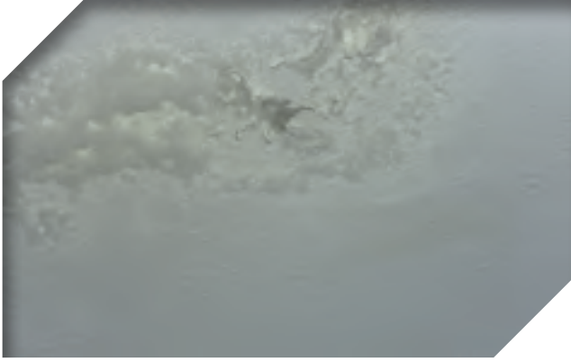
Katlar arası su sızıntısı
