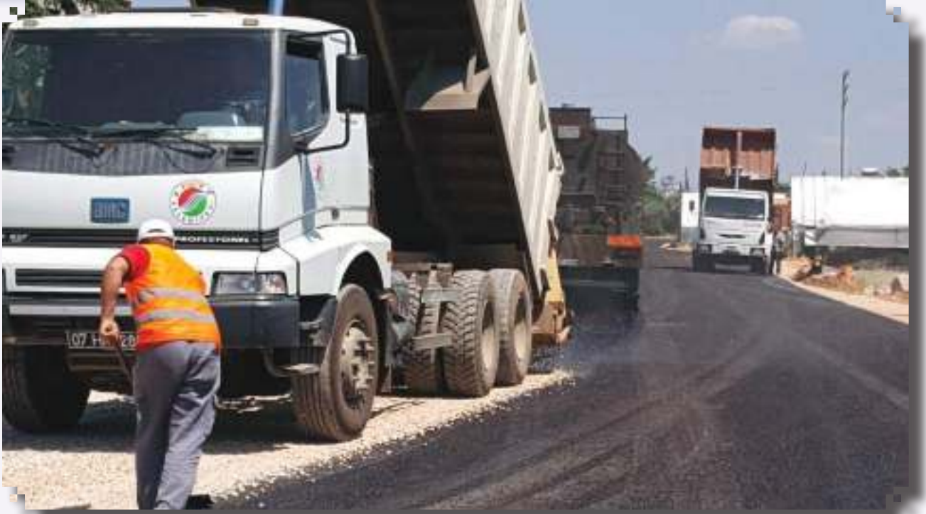
Zeytinlik Mahallesi Sathi Kaplama Asfalt Dökülmesi
