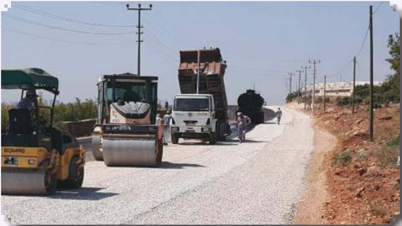
Varsak Esentepe Mahallesi Sathi Kaplama Asfalt Dökülmesi
