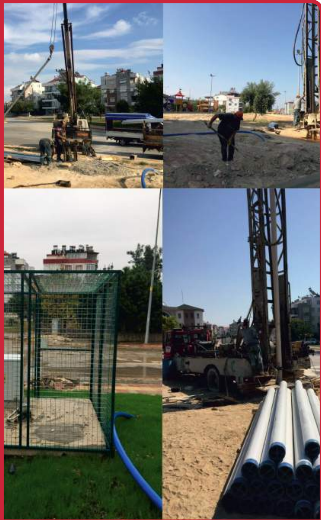
Yeniemek Mahallesi Aliya İzzet Begoviç Caddesi - Ceyhan Cad. Kesişimi Sondaj Kuyusu Açılması
